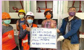
111.3 檢查高壓配電盤
